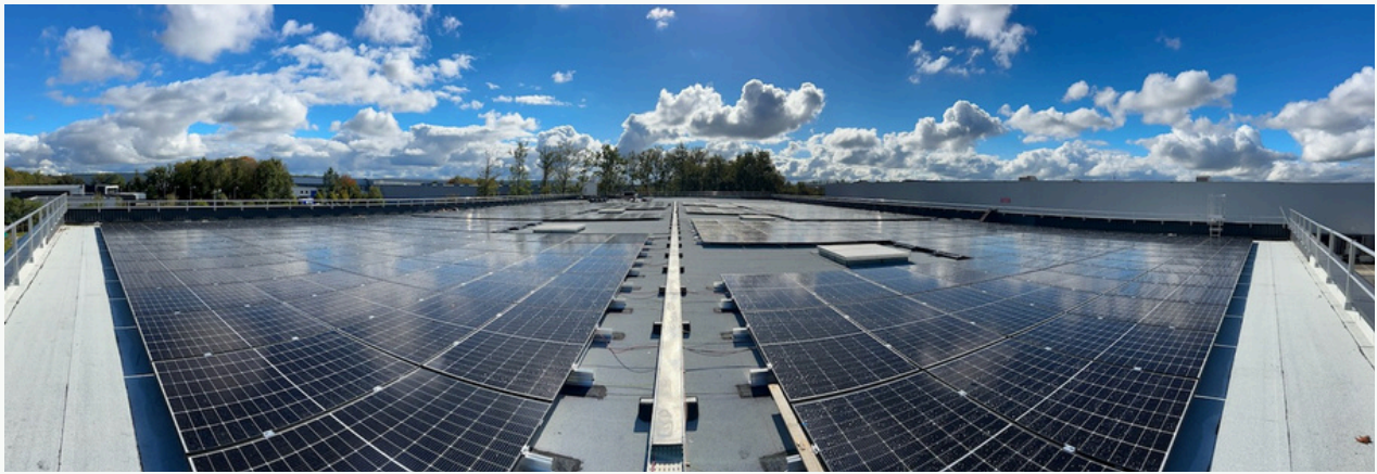
Panneaux solaires - entrepôt d'Options Orléans
